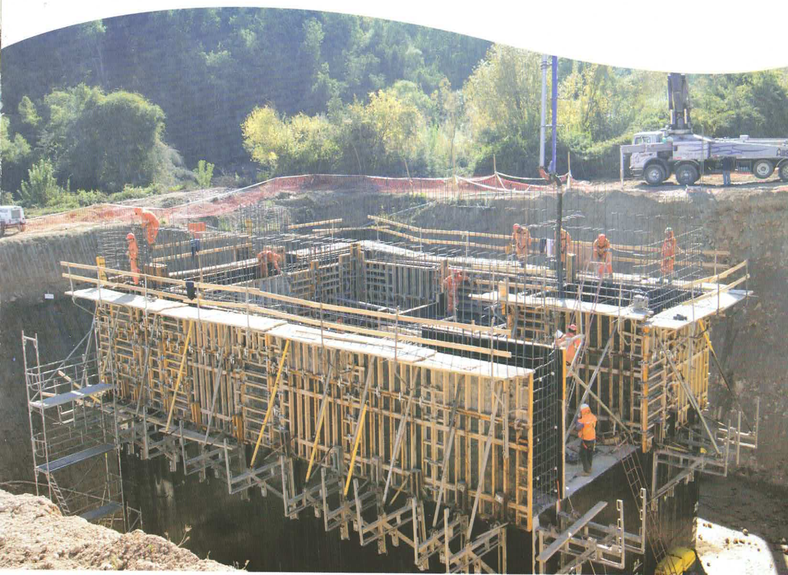
SALA DE MÁQUINAS FUTURA CENTRAL MARIPOSAS
