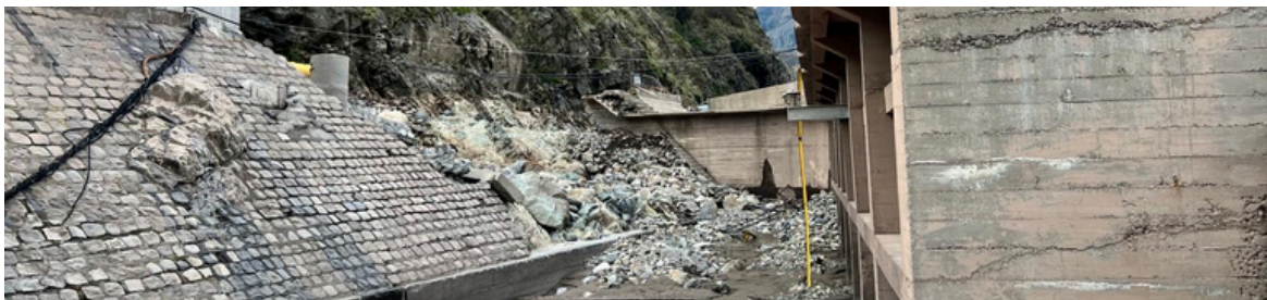
Talud Bocatoma Armerillo Junio 2024
